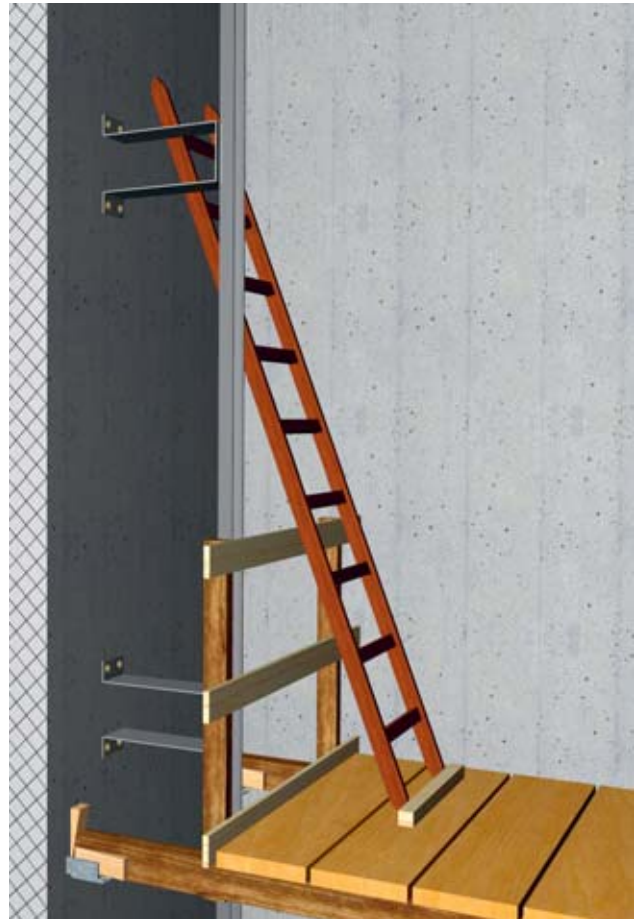
14 Les ouvertures de plus de 30 cm de largeur dans le plancher présentent un risque de chute. Même en présence d'une protection latérale, si l'on se trouve sur une échelle, on se protégera de manière efficace en utilisant un harnais de sécurité et une corde.
